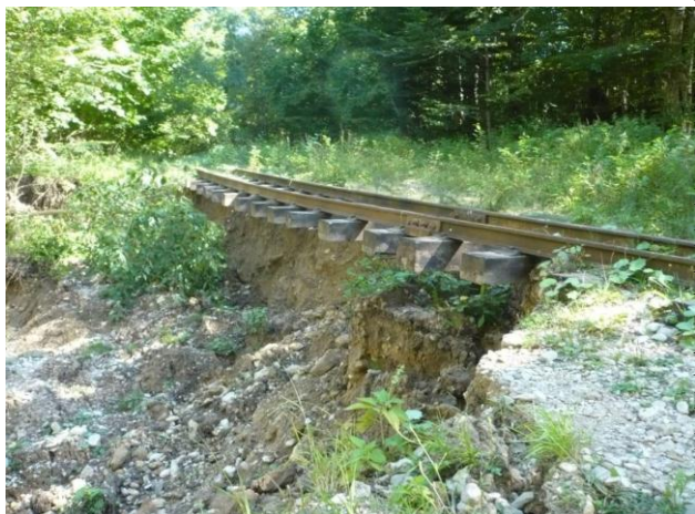
Рис. 1.29. Активный оползневой блок в низовом откосе узкоколейной железной дороги
