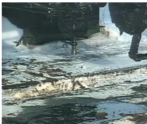
Рис. 1.18. Порыв нитки нефтепровода в пгт Ровное Саратовской области
